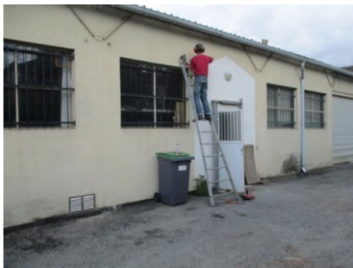
Photo 2 - Installation des supports pour les tringles à rideaux du local. Scelllements extérieurs.
